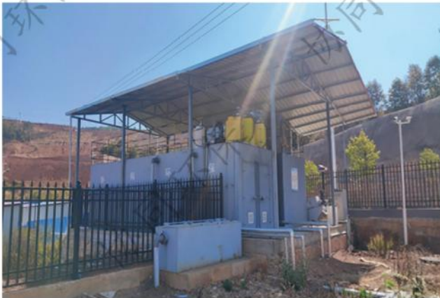
云南古润生物科技有限公司生产废水处理工程
