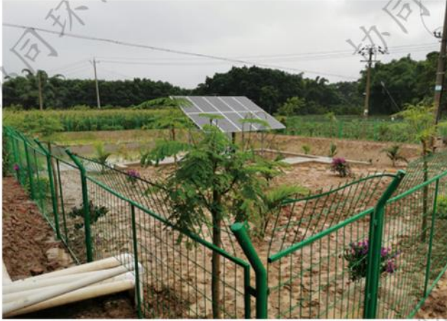
勐海曼恩村委会生活污水处理-太阳能污水处理工程
