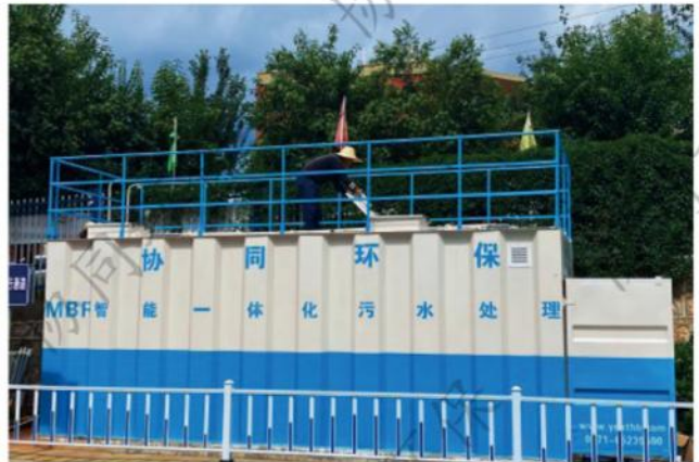
云南安佑饲料科技有限公司一体化生活污水处理工程
