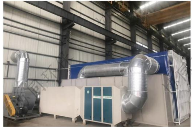
官房钢结构废气治理
