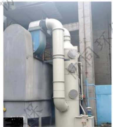
玉溪大红山矿业有限公司废气治理工程项目
