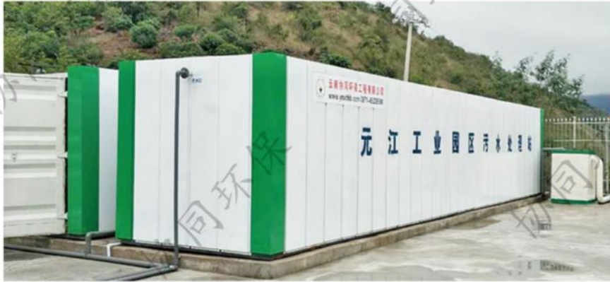
元江工业园区污水处理系统
